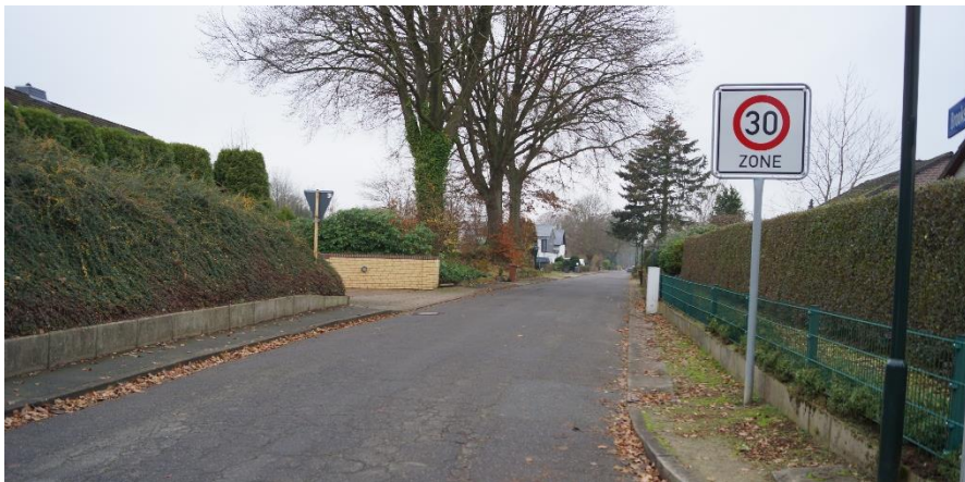
Abbildung 31: Beengte Gehwegesituation in der Brookstraße 33
